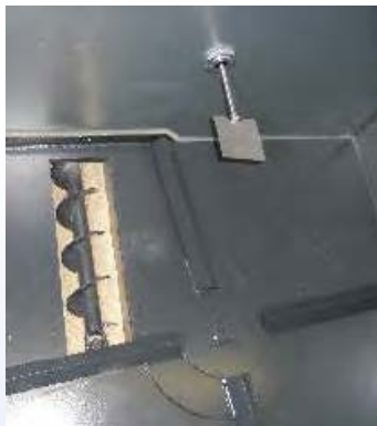
Rührwerk, Förderschneckenverdichter und Füllstandsmelder im Inneren
